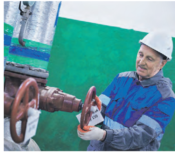
Все работы по подготовке столичной системы отопления полностью завершены, и дома готовы к холодам
